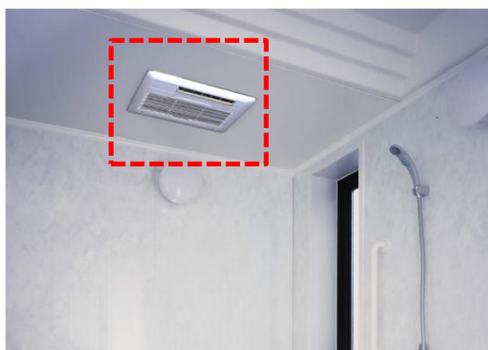
浴室の天井に設置
